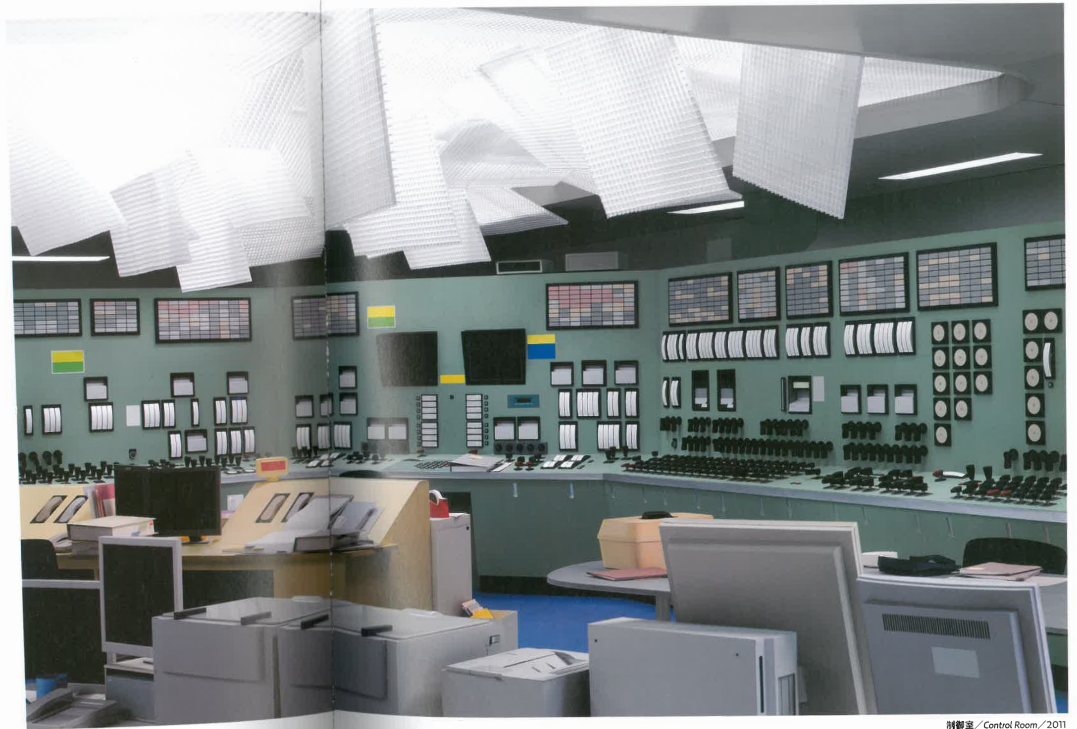
制御室 / Control Room / 2011
